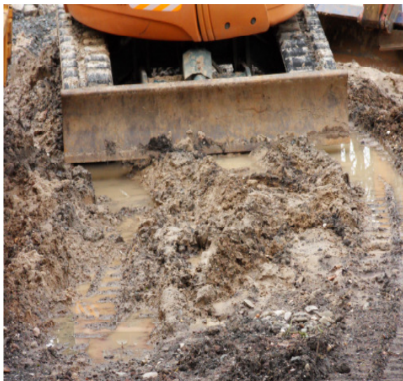
Bild 2: Das Bodengefüge ist zerstört und gibt keinen Gegenhalt
