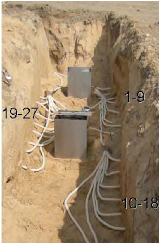
Abb.3: Aufbau der Sickerwasserprobenahme mit zwei Lysimetern und 27 Saugplatten zum Zeitpunkt der Installation
