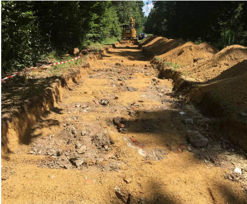
Auffüllungen (Bauschutt, Eisen, Munition)
